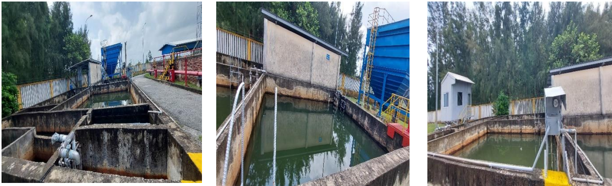
Hình 3.9. Hình ảnh hệ thống xử lý nước thải của cơ sở
