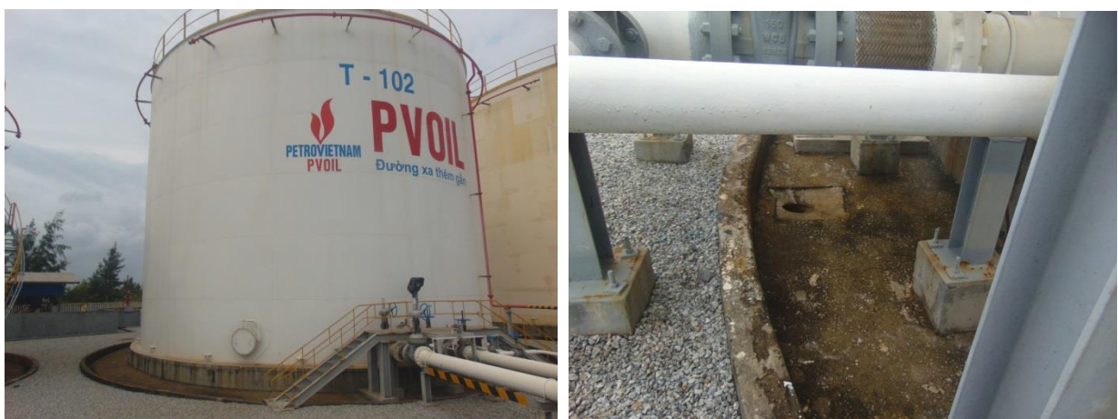
Hình 3. 4. Cụm van tại chân bồn chứa và lỗ thu nước mưa chảy tràn có nguy cơ nhiễm dầu (nước chảy tràn qua khu vực cụm van) về HTXLNT
